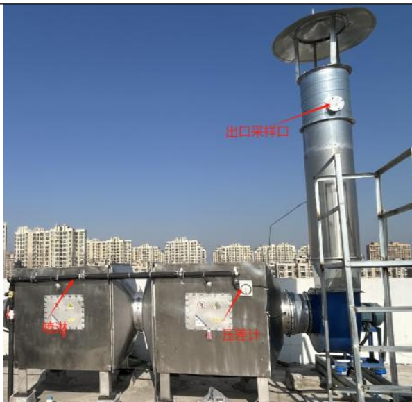
二级活性炭吸附装置配套压差计、喷淋等风险防控措施
