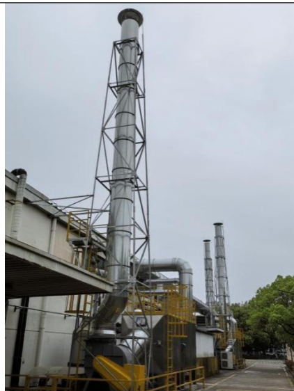
“二级活性炭”及 DA004 排气筒
