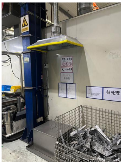
浸油油雾废气集气罩收集
