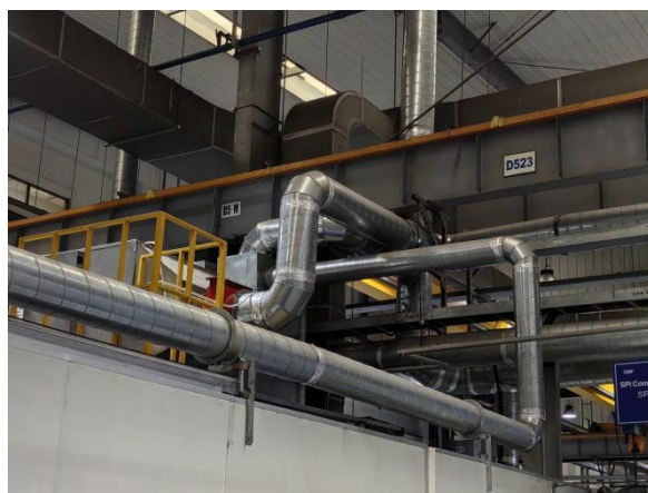
湿法油雾净化+活性炭装置
