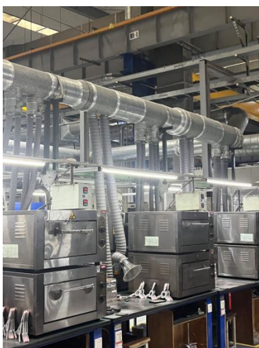
转片点胶废气万向罩、固化废气密闭管道收集
