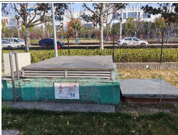
生产废水取样口
