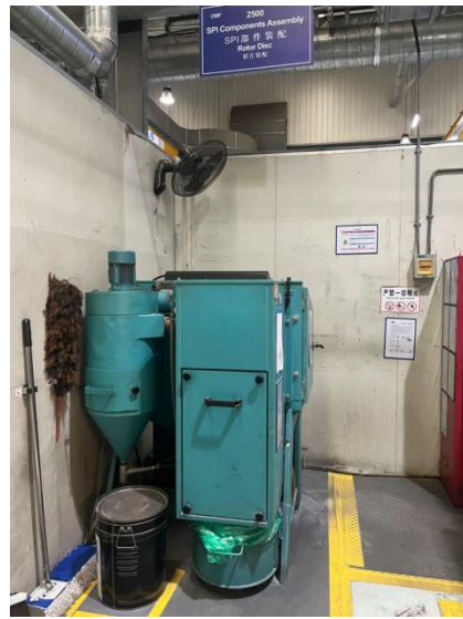
喷砂设备密闭+除尘器
